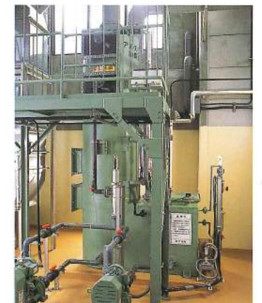
アルカリ活性炭触媒脱臭塔【高濃度】
