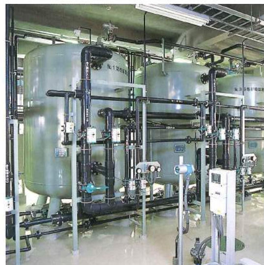
活性炭吸着塔
