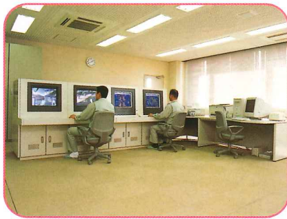
ちゅうおうかんしつ 中央監視室
